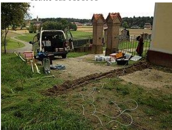
Stromanschluss für A021A Hütte für A021A Mobilfunk und GPS Antennen
